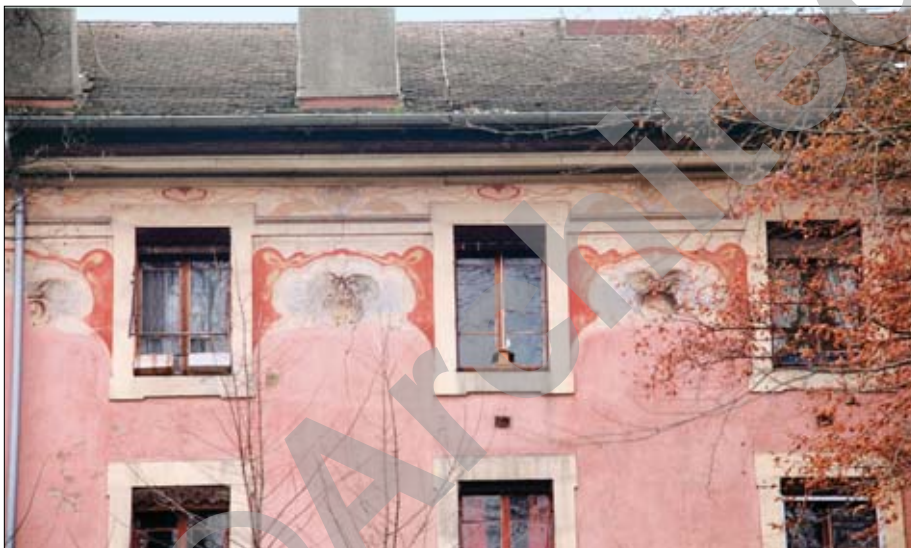
Ornements de façades avant restauration
