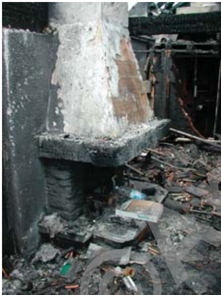
Les combles détruits par le feu
