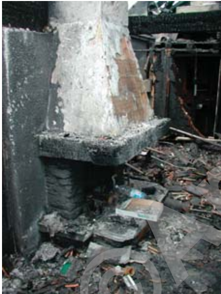
Les combles détruits par le feu
